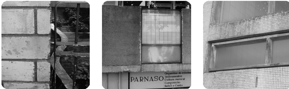
Figura 2: a) Degradação do tijolo vidrado e dos elementos em ferro; b) Alhetas em perfilaria de latão e vidro, nas guardas das galerias de acesso; c) Caixilharia de madeira.
